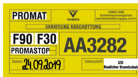
Abbildung 2: Schild - Sanierung Brandschott
